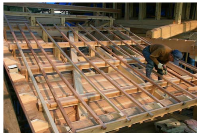
④⑨ 屋根地板の下地と屋根の曲線を作る野垂木の取り付け
