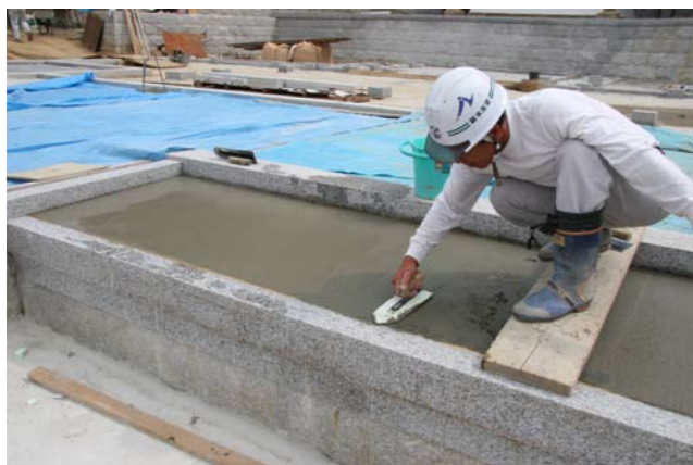
㉔犬走りモルタル仕上げ
